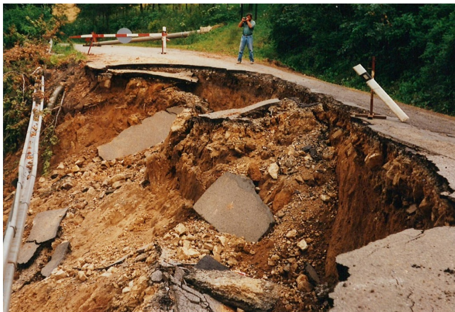
Obr. 9: Zcela zničená komunikace v důsledku sesuvu u přehrady Bystřička z července 1997. Foto: Karel Kirchner.
