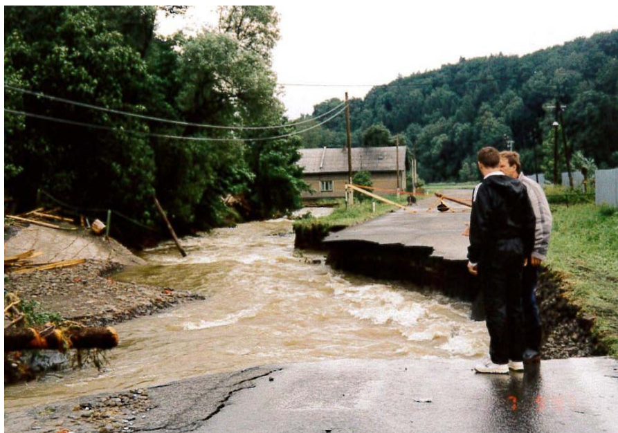
Obr. 10: Další příklad kompletně zničené komunikace vlivem boční eroze vodního toku. Silnice do Lukavce, červenec 1997. Foto: IŽP Moravskoslezského kraje.
